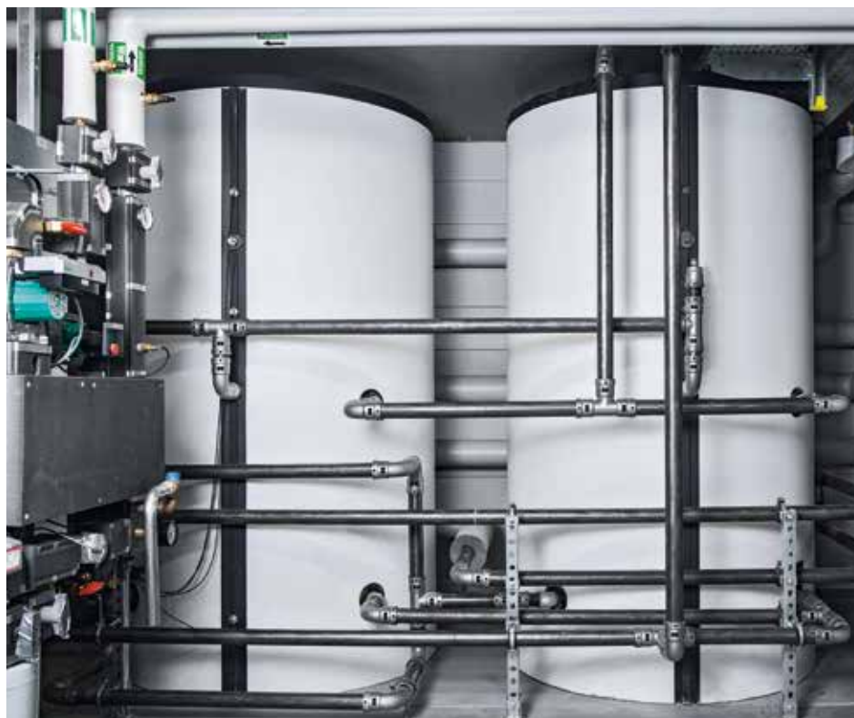
Megapress in een verwarmingsinstallatie met buffervaten.
