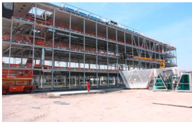
Verspreid over de bouwlagen is het leidingwerk nog goed zichtbaar.
