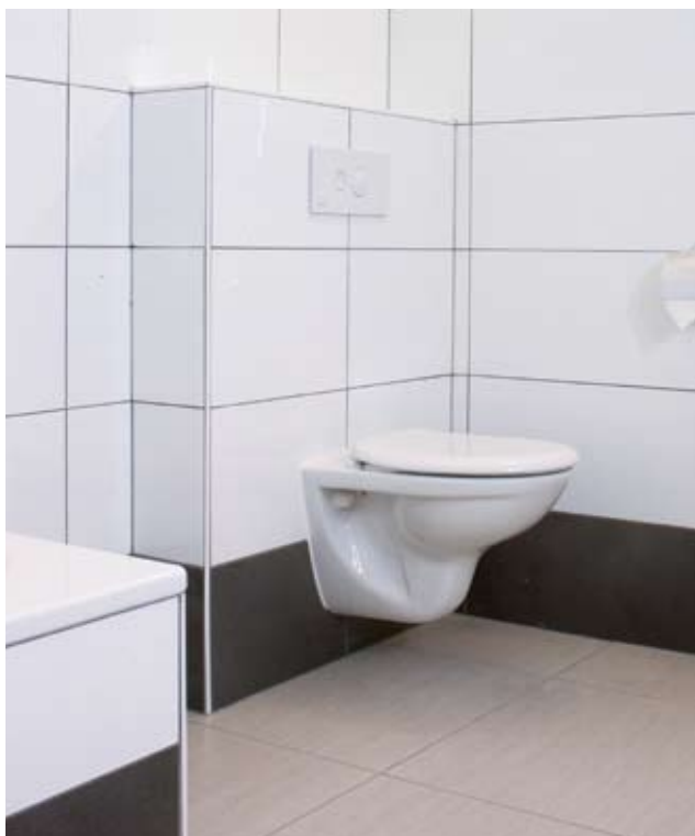
Viega Eco Plus wordt toegepast in alle badkamers en toiletten.
