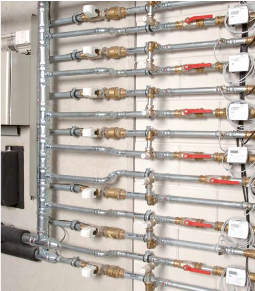
Al het CV-zijdige leidingwerk is uitgevoerd met Prestabo van Viega.
