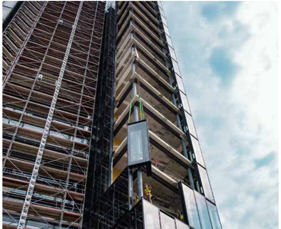
Het hoofdkantoor van Bitzer in Sindelfingen: op 70 meter hoogte uitgerust met waterleidingsystemen van Viega.
