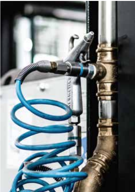
Het waarborgen van een efficiënt gebruik van perslucht: Viega buisleidingsystemen.
